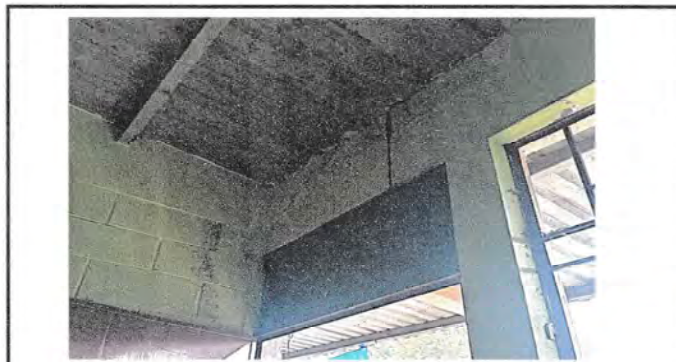
Foto 4: Costaneras en mal estado en la parte frontal de la escuela con medidas de 70 metros cuadrados, correspondiente al corredor de la misma.
