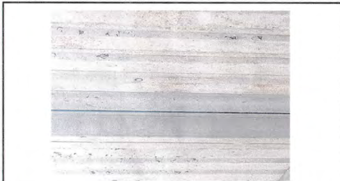
Foto 1: Lámina con perforaciones en mal estado, en cinco salones de clase con medidas de 6 x 8 metros y parte del corredor de 2.5 metros de ancho.
