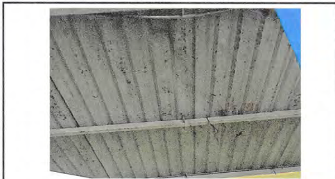
Foto 3: Costaneras con óxido en gran parte de la armadura metálica de los cinco salones de clases y una bodega, las cuales necesitan mantenimiento como lijado y pintura.
