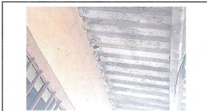
Foto 2: Lámina con óxido en gran parte del techo de cinco aulas con medidas de 8 x 6 metros, una bodega de 12 metros cuadrados y el corredor de la escuela de 2 metros de ancho.
